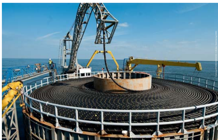
Ein Drehstromkabel von 60 km Länge und 3.500 t Gewicht bindet den ersten deutschen Offshore-Windpark alpha ventus an das deutsche Stromnetz an
